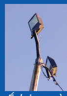
Éclairage à remplacer
