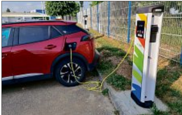
Trois bornes électriques doubles opérationnelles.
